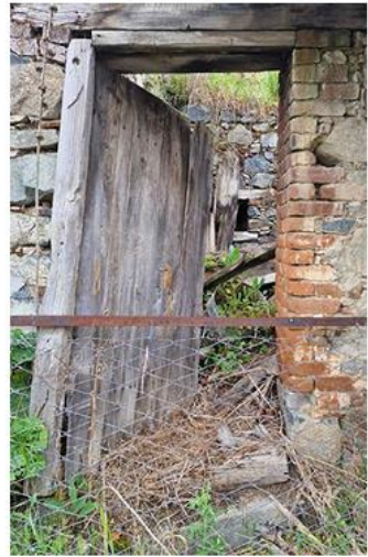
Κατάρρευση Σιδηρής Ξύλινης Πόρτας
