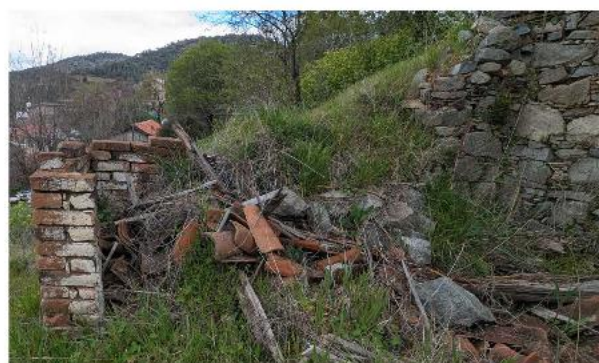
Καταστροφή περιμετρικής λιθοδομής
