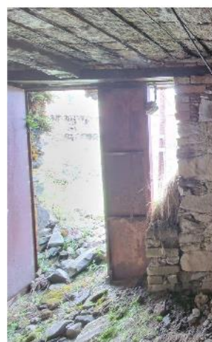
Καταστροφή τοίχου περιμετρικά θυρώματος
